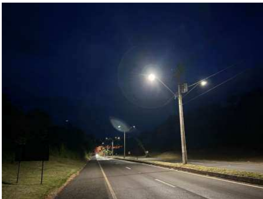
Figura 58 - Iluminação da Estrada Municipal Pedro Bosco
