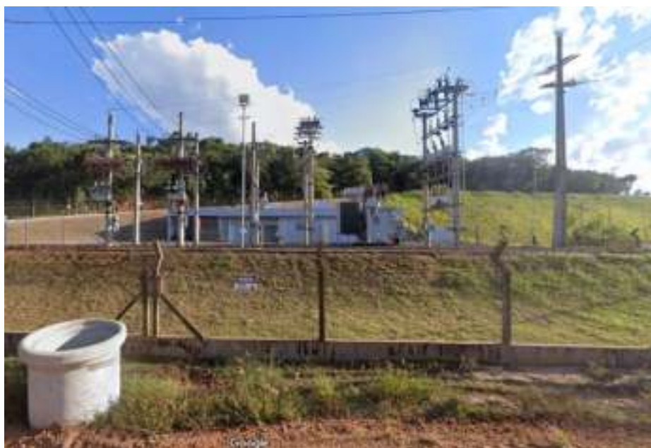
Figura 89 - Subestação da CPFL em Bofete
